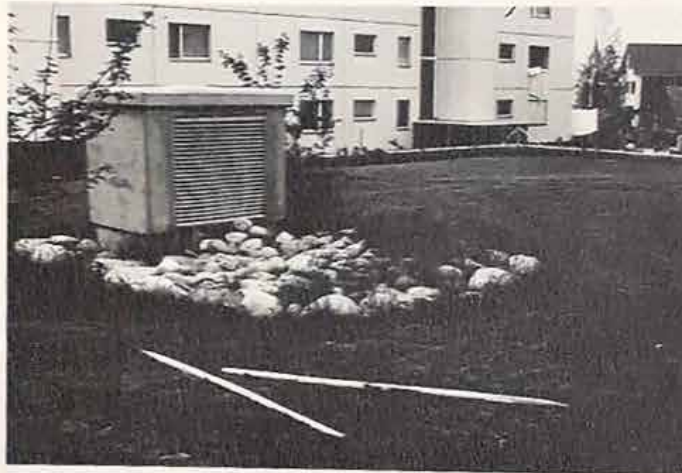
«Neun Entlüftungsschächte, die die Abgase aus den Einstellgaragen direkt auf die Spielplätze blasen.»
